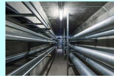
停電による研究成果の消失や配管破損による危険物の流出を防止
