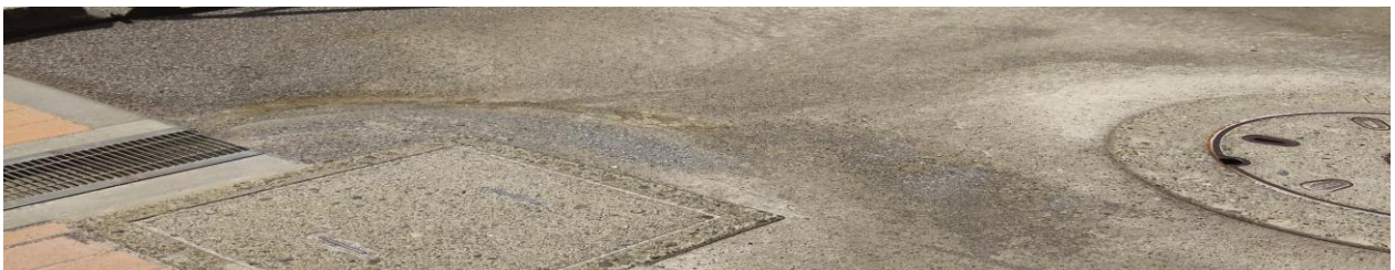
保健室前の校庭にできた雨水の流れの跡
