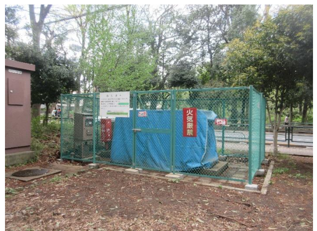
石神井公園内の井戸とポンプ
