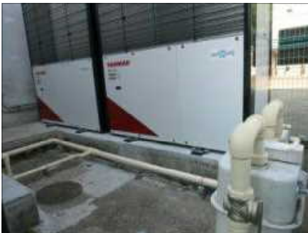
正門左に設置したガスエアコン室外機 (左が1年EF組用室外機、右が1年CD組用室外機)
