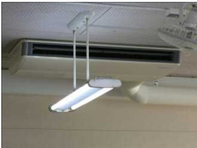
1年D組教室のガスエアコン
